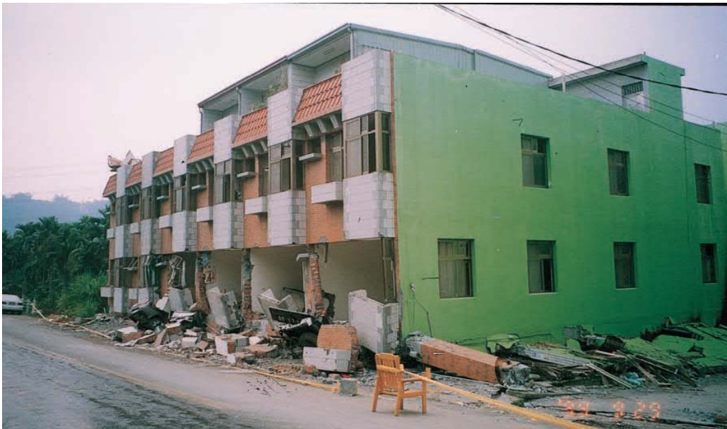
921集集地震: 南投縣某三層樓街屋底層塌陷 (照片來源: 蔡萬來技師)
