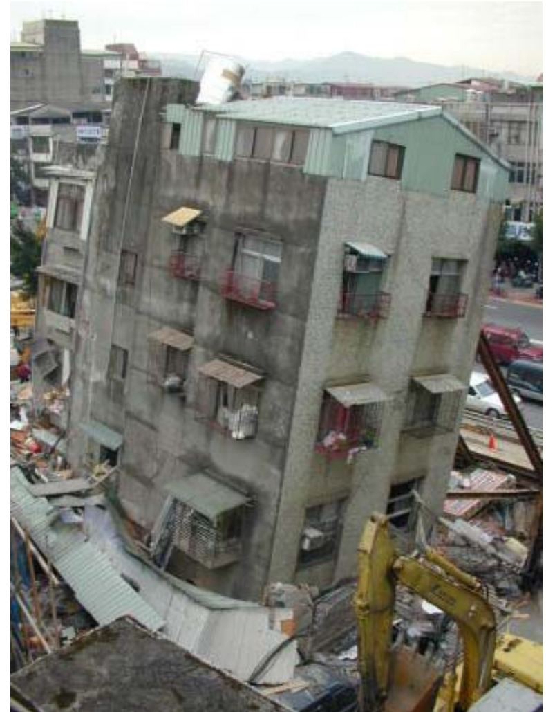
331花蓮地震: 臺北市某五層樓公寓底層塌陷( 照片來源: 國震中心)
